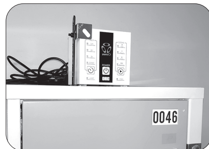
プール及びアリーナ更衣室に オゾン発生器を設置しました
